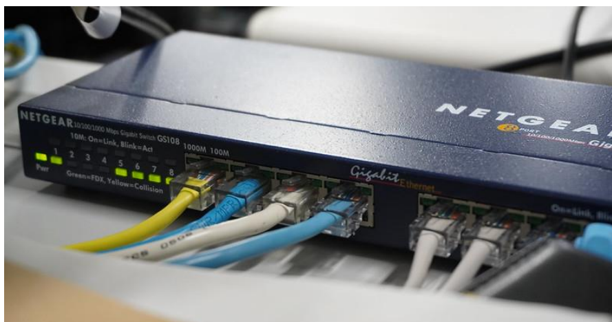
Slika 2.10.1 Mrežni preklopnik s uključenim ethernet kabelima
